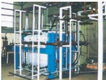
リサイクル設備
